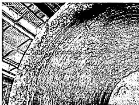
Figura 52 - Desgaste do revestimento refratário na panela de aço.
