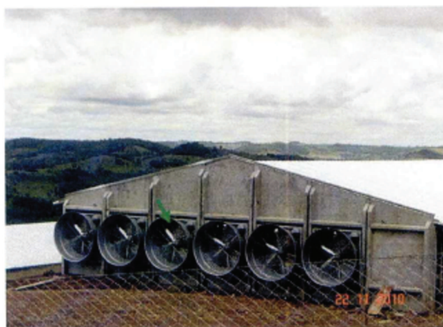
Sistema de ventilação por exaustores
