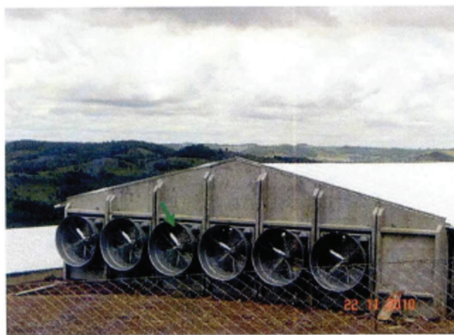
Sistema de ventilação por exaustores
