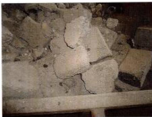
Tijolos refratários gastos e substituídos
