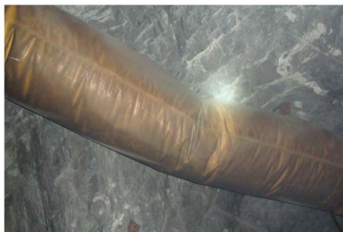
Duto para ventilação forçada no interior de uma galeria.
