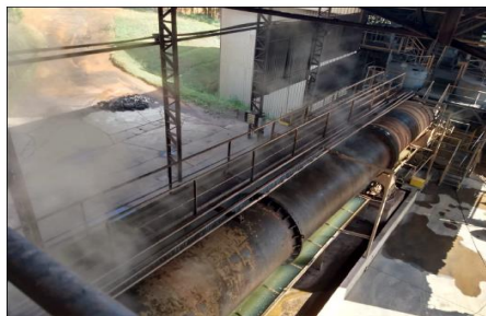
Figura 13. Sistema de resfriamento dos propantes obtidos após a sinterização.
